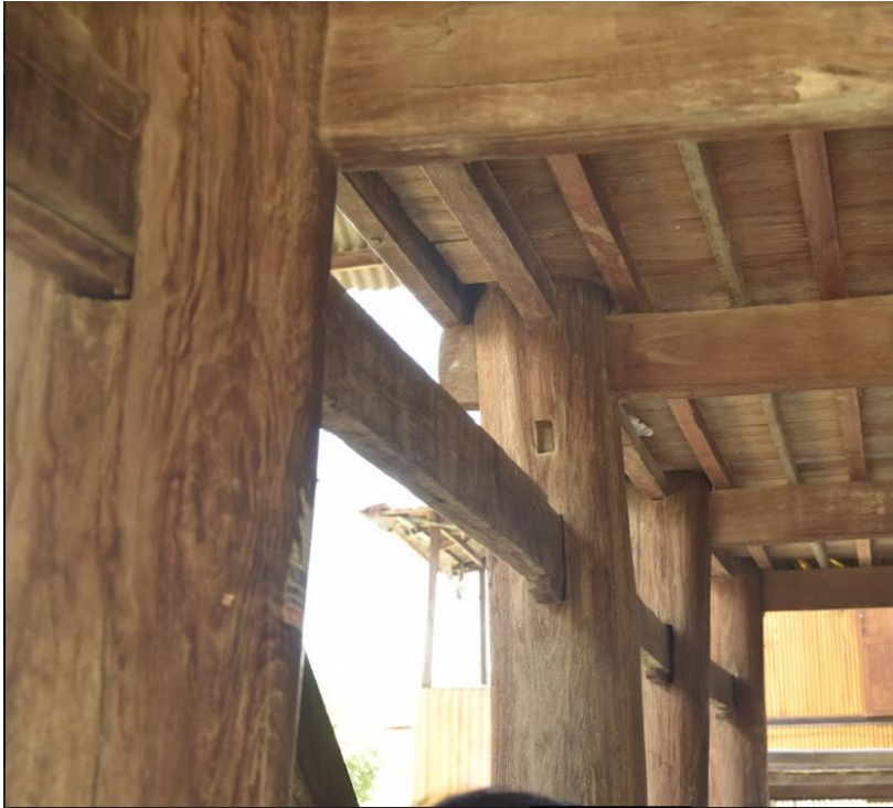
Figure 46 : T7 sambungan kayu pada bagian tangga dan lego-lego, Sumber : photographr Andi Abidah & Taufiq Natsir
