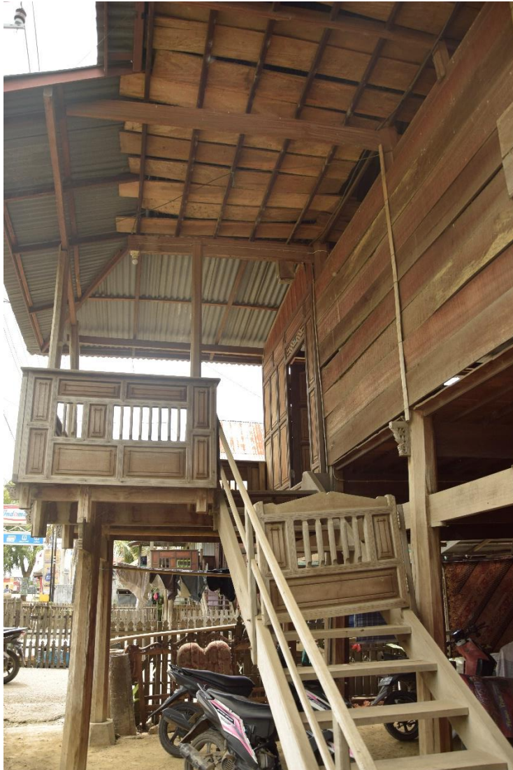
Figure 25 : T3 Tangga dan sistem konstruksi pada bagian bawa rakkeang, Sumber : Andi Ab
