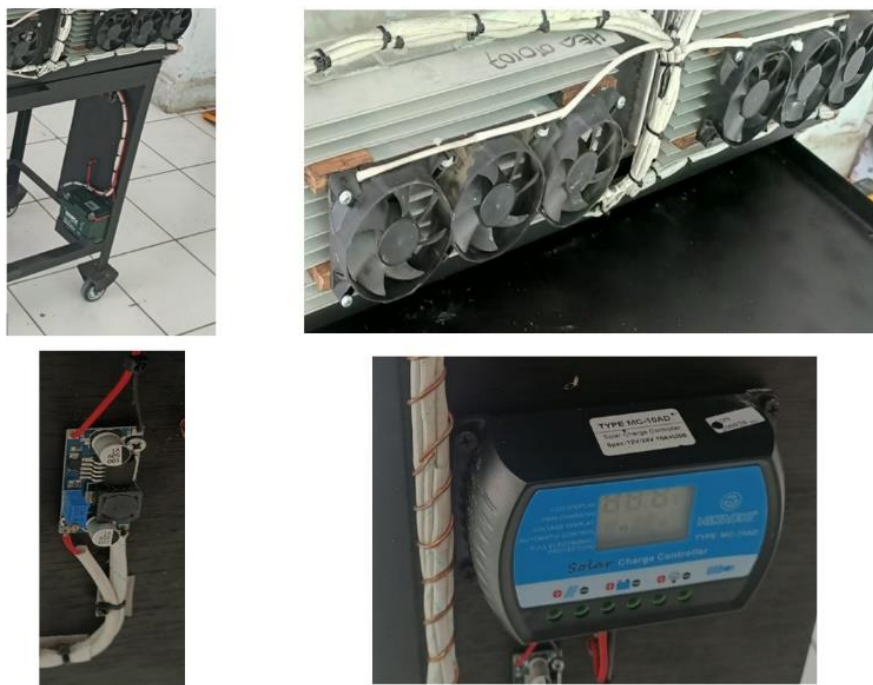
Gambar 11. Akumulator, Step Up Tegangan, Carger Akumulator, dan Kipas Pendingin.
