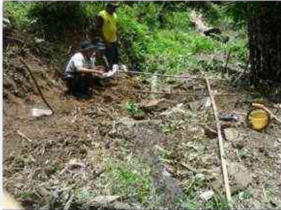
Gambar 2. Sekelompok masyarakat membuat bangunan penangkap mata air di Kawasan hutan sebagai wujud dari upaya menyeimbangkan ekosistem.
