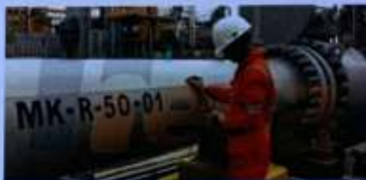
Gambar 2.5 Pengujian ultrasonik di lapangan untuk memantau korosi pipa (Khoeri, 2017).
