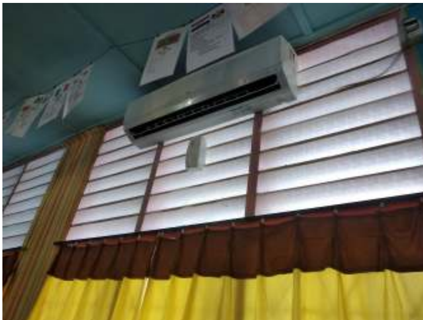
Gambar 4. Alat pendingin ruangan (AC) SD Negeri 3 Unggulan Kota Parepare (SD Negeri 3 Unggulan Parepare, 23 Juli 2019)
