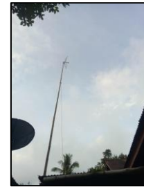
Gambar 8. Tower jaringan yang terbuat dari bambu
